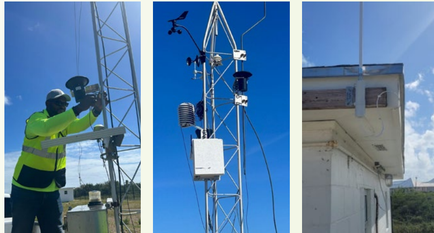
Instalaciones de los sistemas meteorológicos automatizados financiados por el CCRIF en los aeropuertos de Gran Turca y Caicos del Sur
