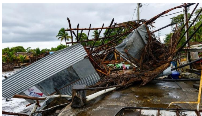
Figura 5 Daños a la costa en Paso Caballos, Corinto, Nicaragua. Fuente: Corinto Mayor's Office FB
